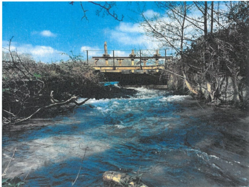
Photo 2 : Vannage de dérivation (ROE88748)
