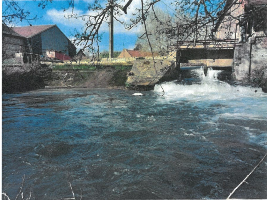
Photo 1 : Vannage de décharge et déversoir (ROE88749)
